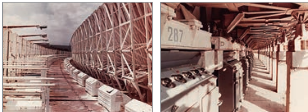
Рис. 44. Слева – верхняя галерея кругового отражателя, шкафы электроаппаратуры приводов. Справа – нижняя галерея кругового отражателя, пульта отсчетно-установочных устройств.
