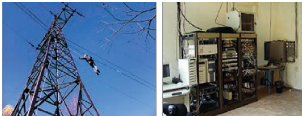
Рис. 51. Слева - прокладка оптического волокна ННП-ВНП; справа - серверное помещение в к. 412 лабораторного корпуса.
