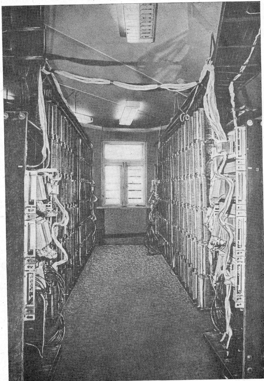
Рис. 7. Вид на оборудование внутри узла 1а (2а).
